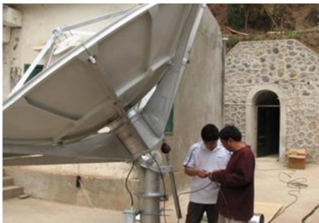
Lắp đặt thiết bị truyền số liệu tại trạm địa chấn Sơn La
